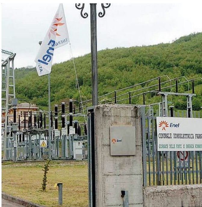
La centrale idroelettrica Enel di Farneta di Montefiorino
