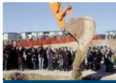
Pedemontana veneta Il costo della superstrada è previsto di 2 miliardi e 391 milioni di euro: affidamento in project financing
